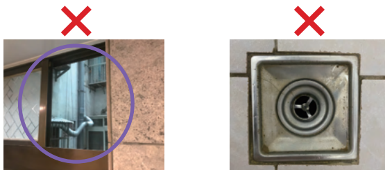
Jendela eksterior tidak dilapisi kasa
